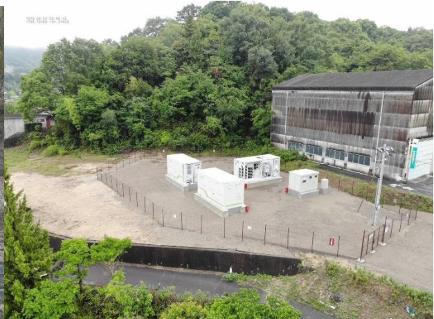
尾道向島蓄電所
